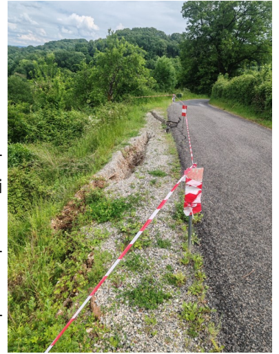
Effondrement à la Combe de Bouzols
